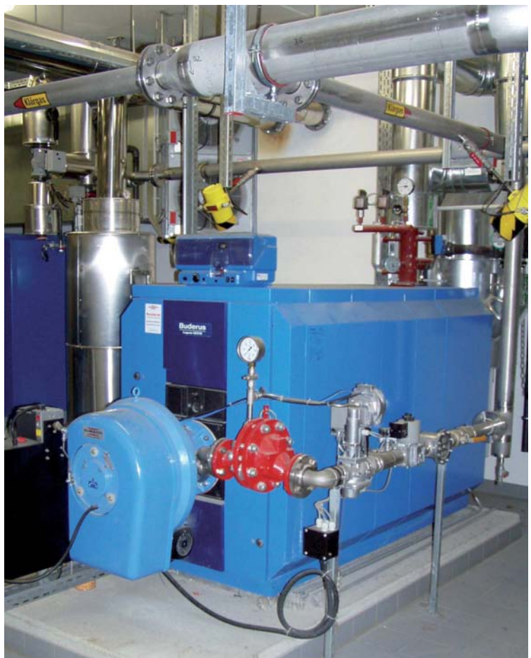
Kesselanlage einer Kläranlage
